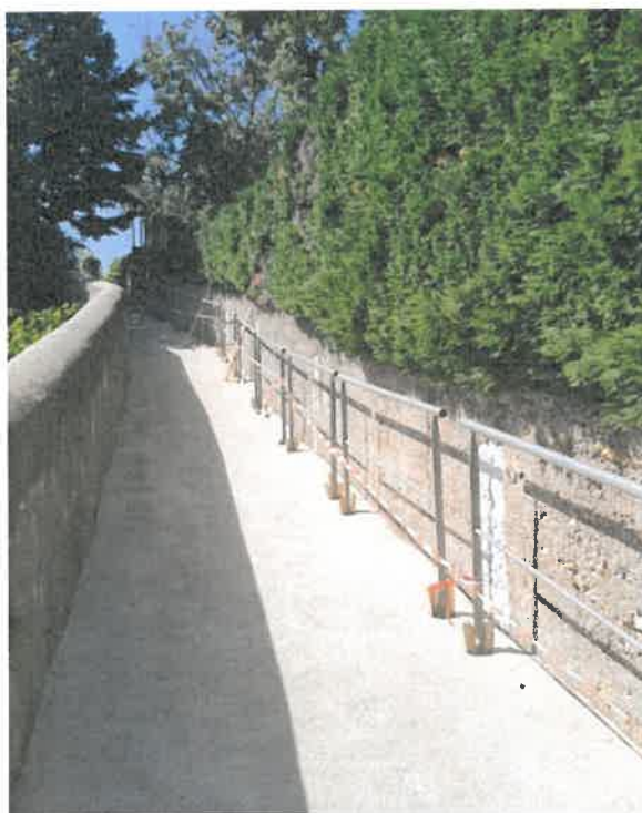
Installation d'une main-courante entre la rue de la République et le chemin de la Brialle
